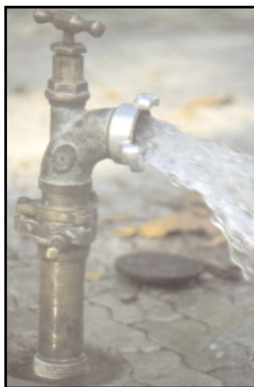
Boca de riego con una salida
